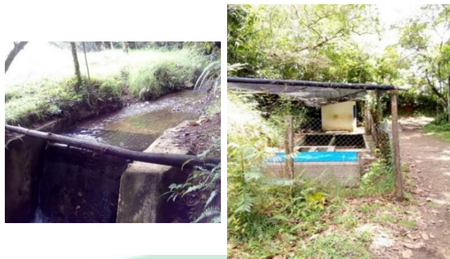
Foto No.18. Captación de agua del cauce principal del río Molinoyaco, para uso del casco urbano de municipio del Tambo.
