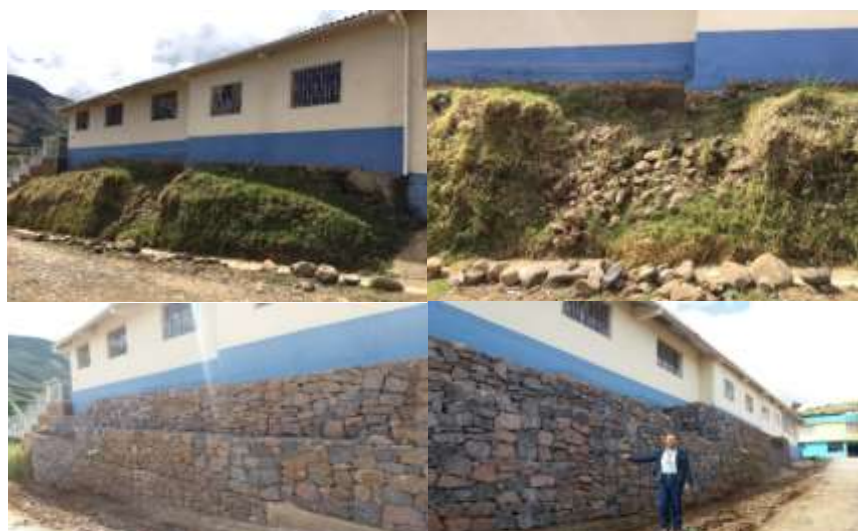
Foto 8. Muro de contención en gaviones en la Institución Educativa Santa Rosa de Lima municipio de Buesaco
