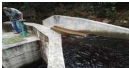
Foto No. 5. Captación Acuabuesaco
