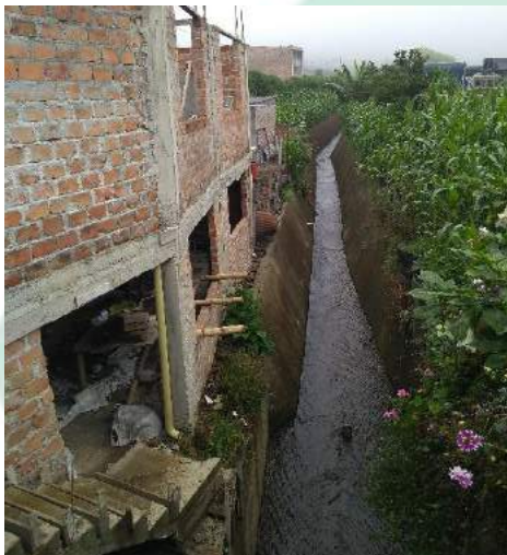
Foto No. 17 Seguimiento realizado al municipio de Guaitarilla-inadecuados vertimientos de viviendas urbanas
