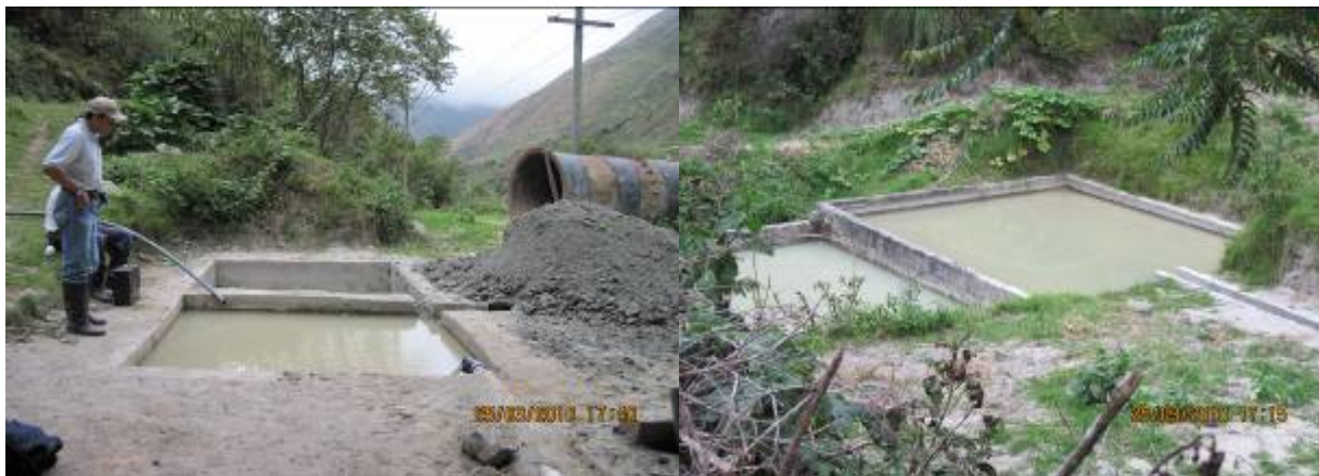
Foto No.13. Planta de vertimientos mina La Casualidad municipio de Mallama.
