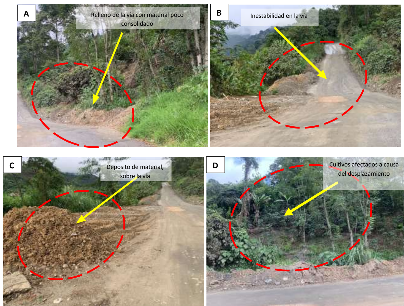
Figura 7. A. Relleno en la vía con material poco consolidado. B. Inestabilidad en la vía C. Depósito de material sobre la vía. D. Cultivos afectados a causa del desplazamiento.
