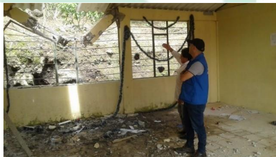
Foto No.10 afectación por movimiento en masa en el municipio de Tambo
